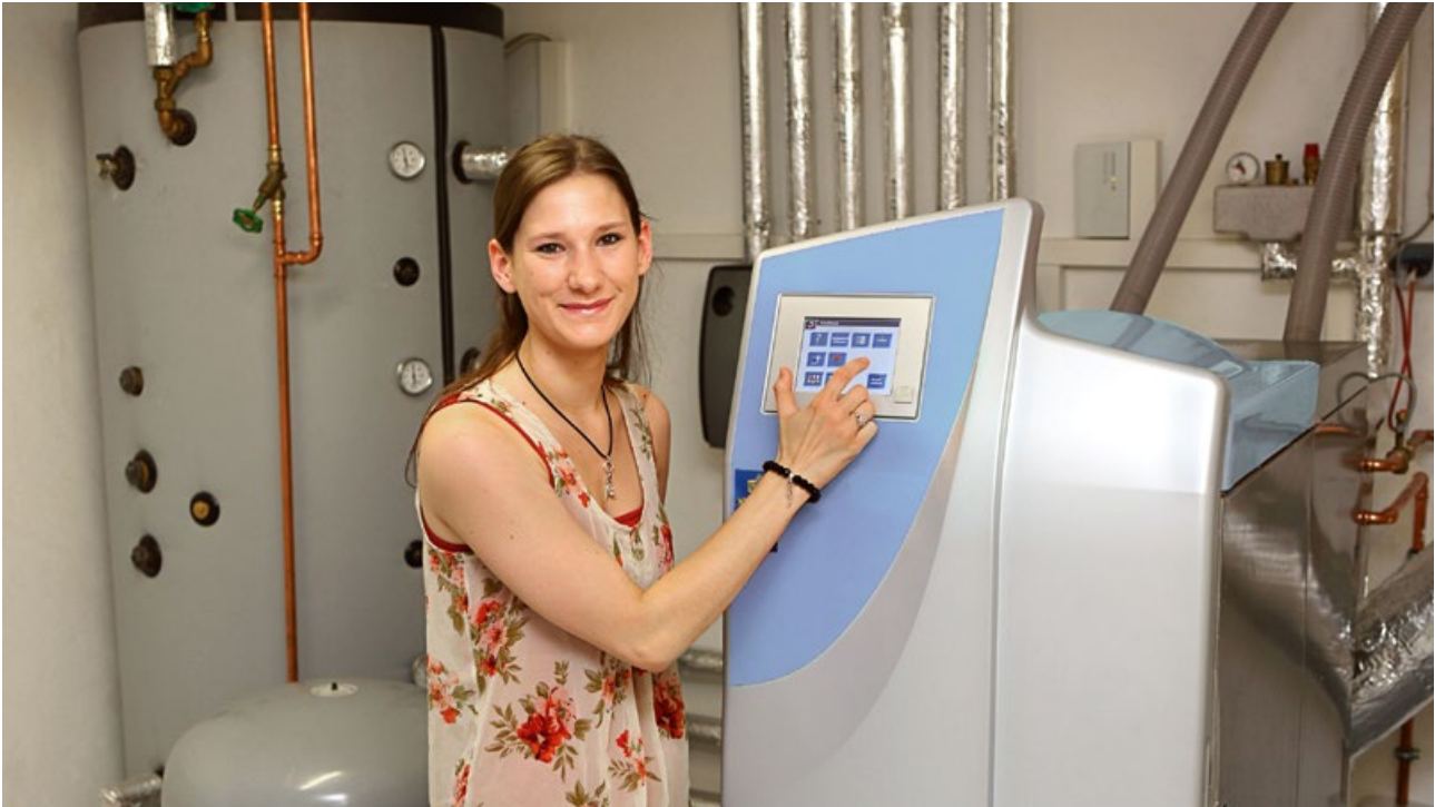
Moderne Holzfeuerungen sind nicht nur äußerst effizient und wartungsarm. Sie lassen sich auch ganz einfach steuern.
