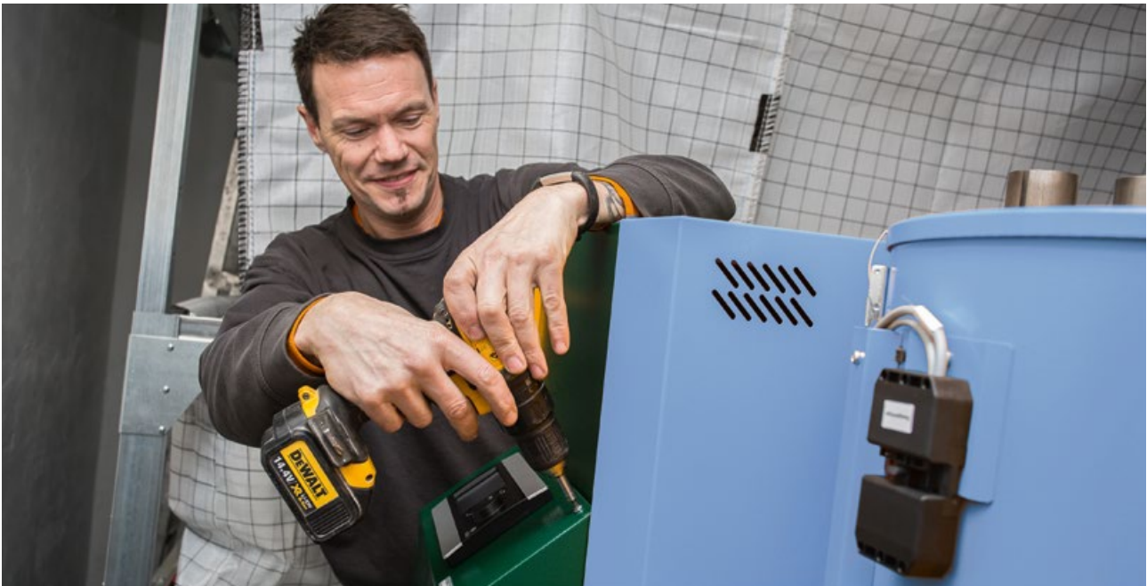
Die Installation des Pelletkessels wird genauso bezuschusst wie das Lager oder Neubau/Anpassung des Schornsteins.
